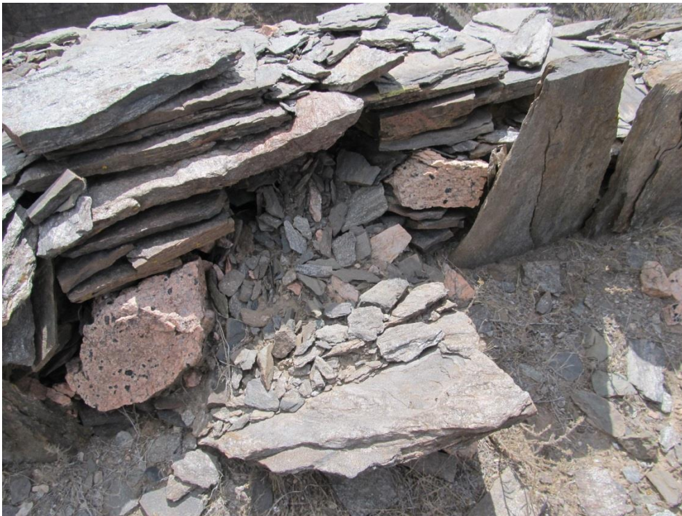
Perdida de materiales y consecuente desplome de muro.
