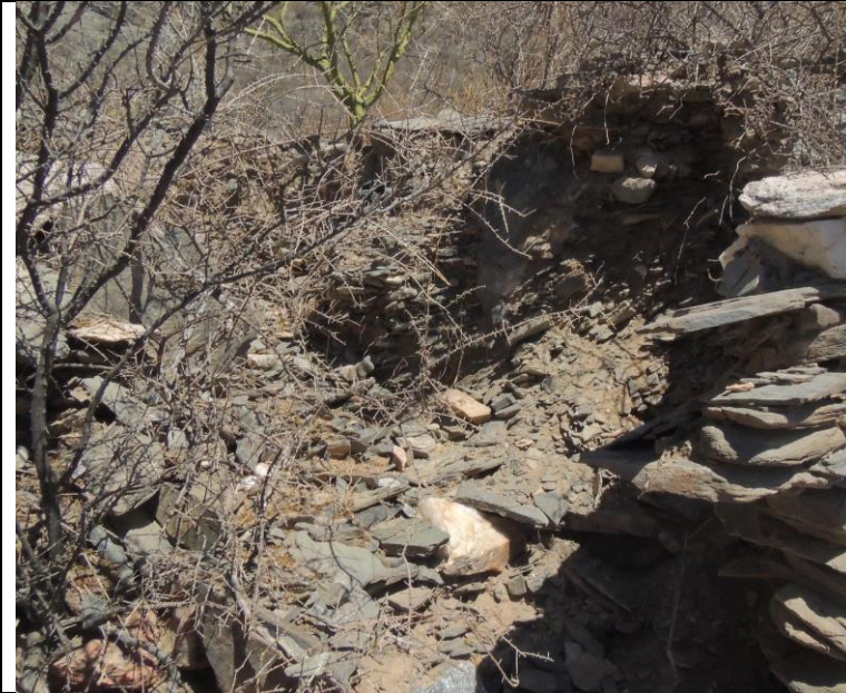
Muro plaza 111 antes de la intervención
